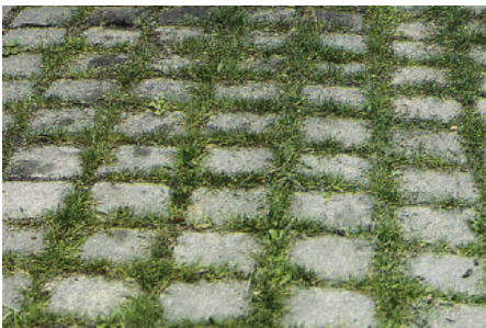
Abb. 1: Pflaster mit offenen Fugen
