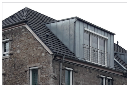
Abb. 4: Beispiel für zu große, optisch störende Dachgaube zum Straßenbereich
